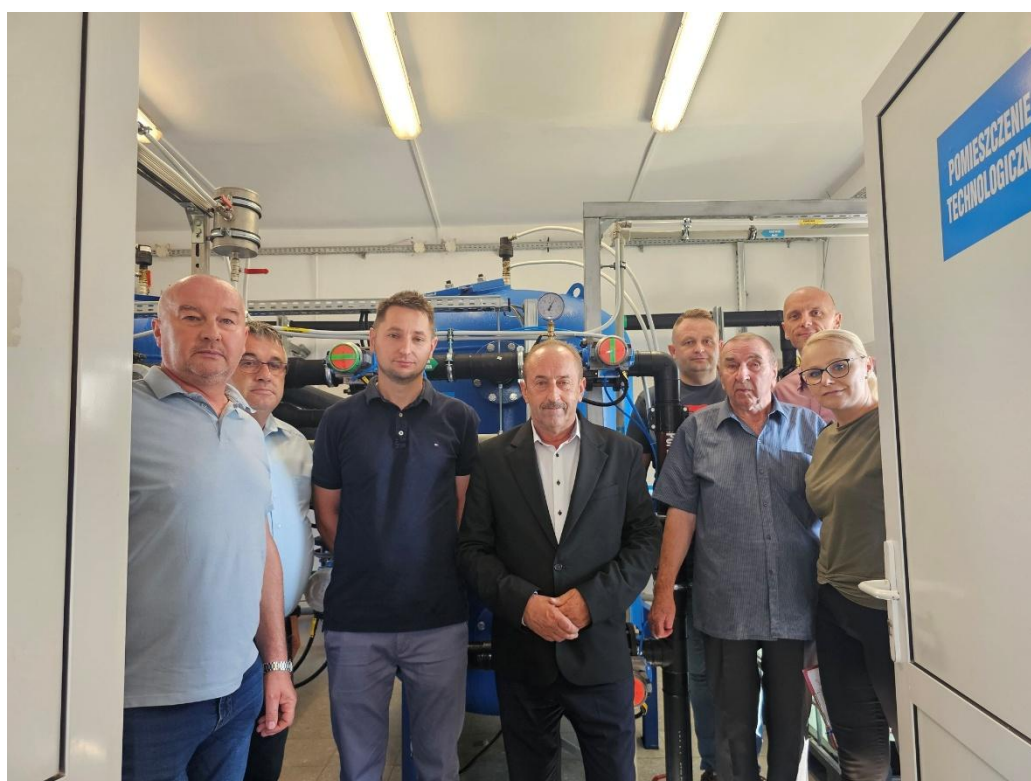
Komisyjny odbiór stacji uzdatniania wody
